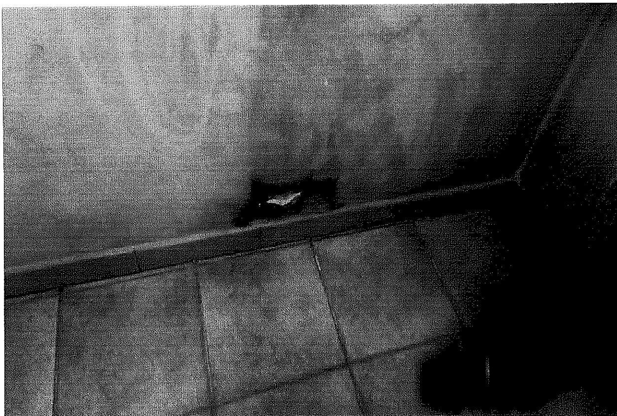
Foto 11 : Piccola risalita di umidità lungo le pareti
