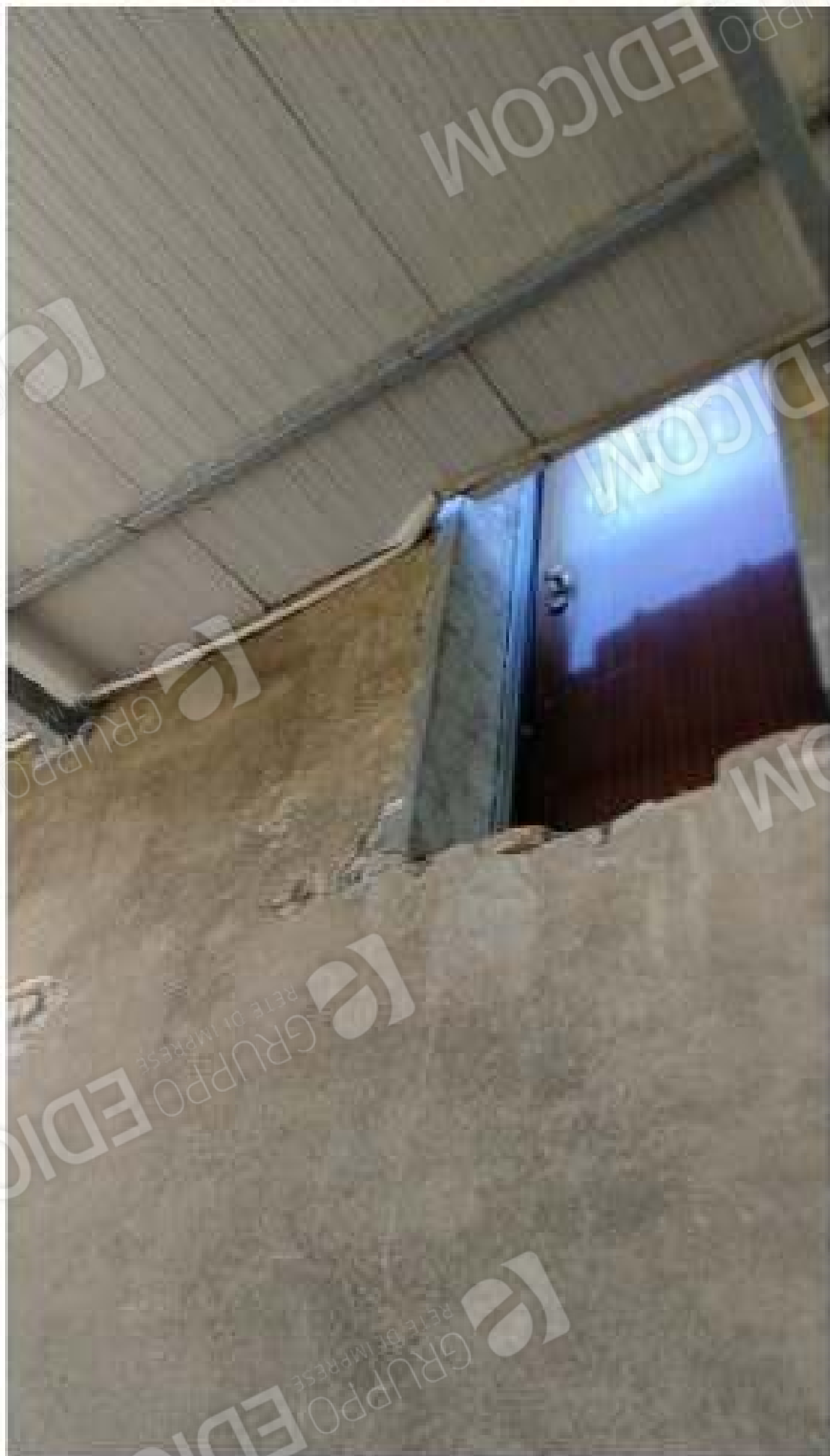
Apertura non autorizzata visibile da tettoia non autorizzata (fabbricato principale)
