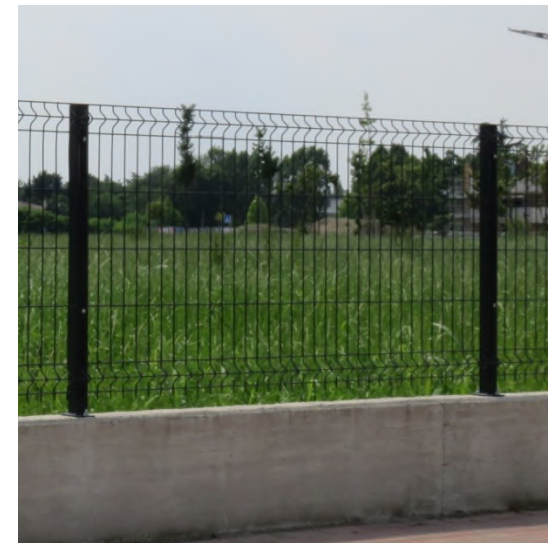
Recinzione esterna in acciaio pannelli modulari di rete elettrosaldata
